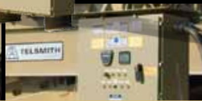
Los paneles de control se separan para la operación
